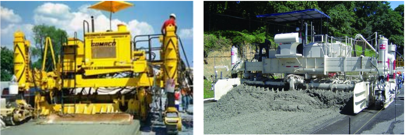
Рис. 6.7. Общий вид бетоноукладчиков.
